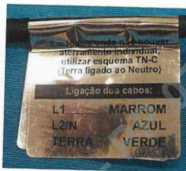
Foto 8 - Fiação externa da amostra.
